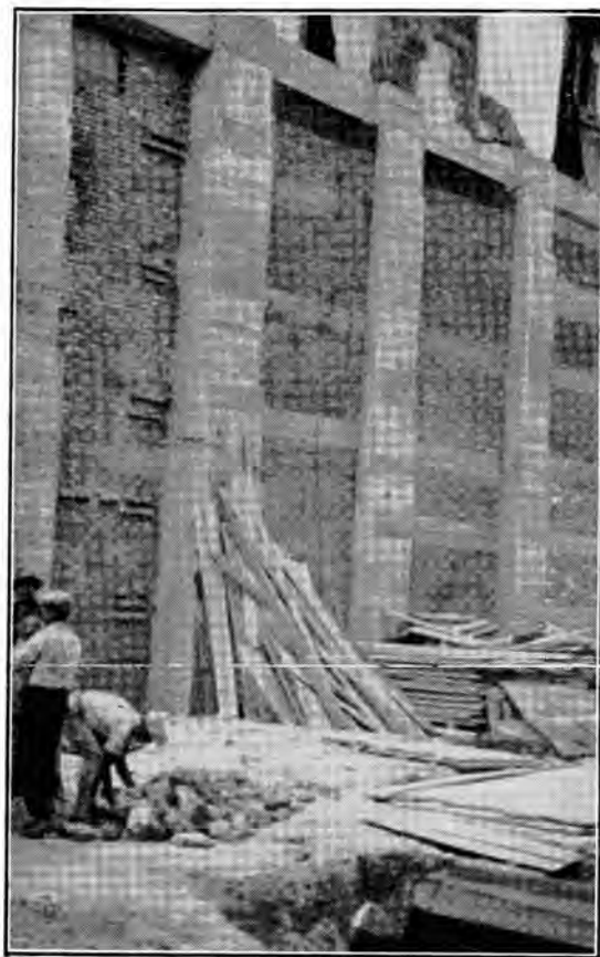
Speroni e muro di consolidamento nel tratto del coro della Chiesa.
